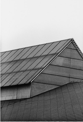
Depotstrasse 43: Firstoblicht mit in Glas eingegossener Fotovoltaikanlage.
