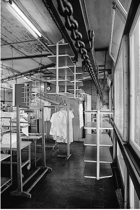
Weihergasse 11: Transportanlage, im Neubau 1955 eingebaut. Belegstück im Rahmen des Umbaus im Gebäude erhalten.
